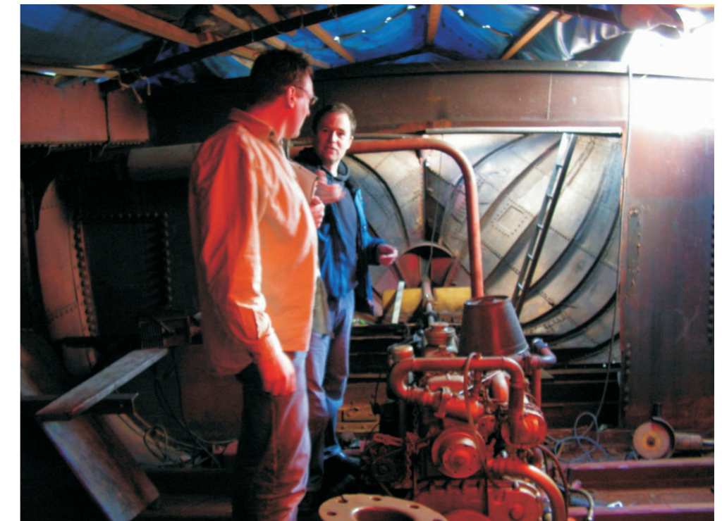
Fred en Rob in gesprek over de installatie van de motor.
